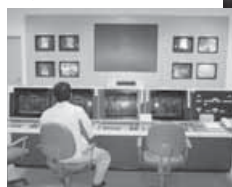
クリーンセンター 中央制御室
