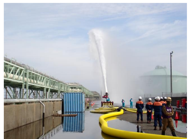
放水砲による実放水
